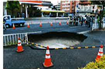
神奈川県横浜市の道路陥没 (2020/07)
