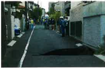
東京都調布市での陥没 (2020/10)
