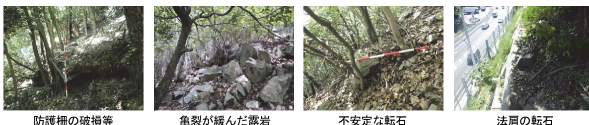
写真－3.1.1 現地調査で確認された斜面の状況
